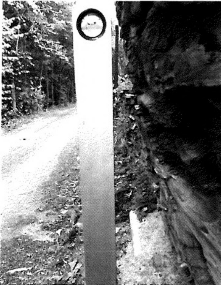
Obrázek 6 - naklonění opěrné zdi
