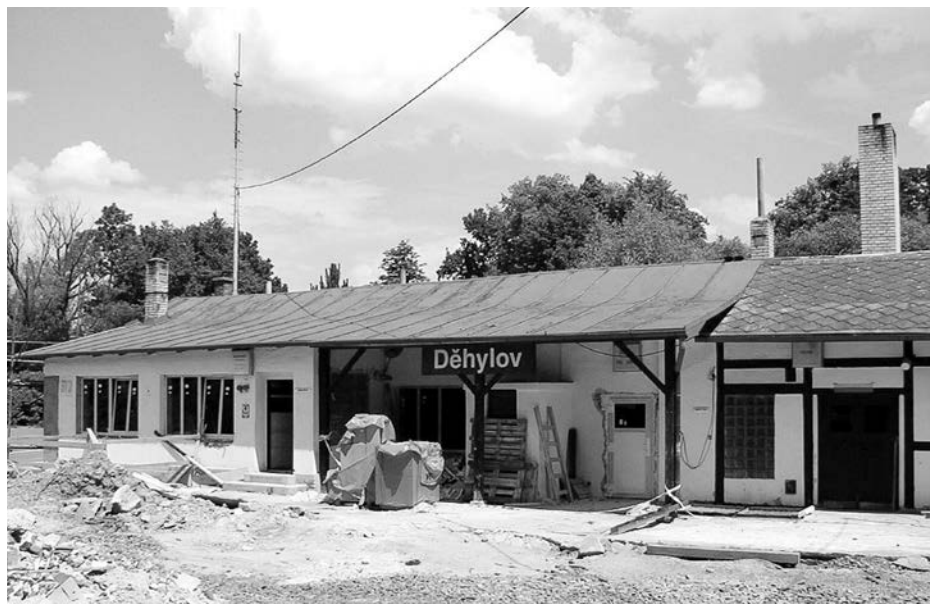
ELEKTRIFIKACE TRATI Opava - Ostrava byla dokončena až v roce 2007. Foto pochází z rekonstrukce stanice Děhylov. FOTO REPRO KORIDORY.WZ.CZ
